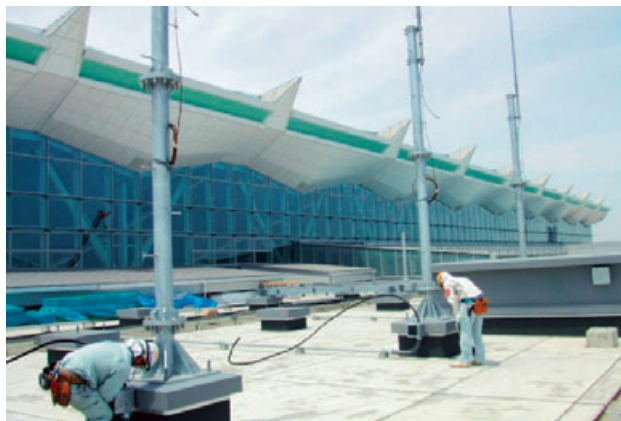
東京国際空港国際線地区旅客ターミナルビルA・B工区 (シーリング防水工事)
